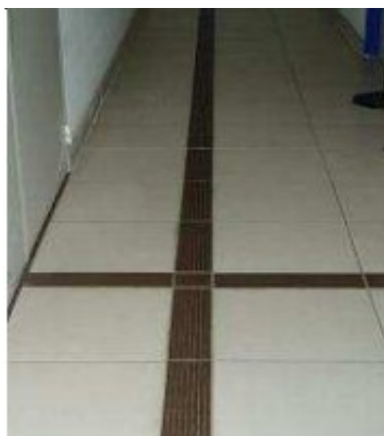
Exemple de carrelage de guidage (21)
