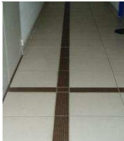
Exemple de carrelage de guidage (21)
