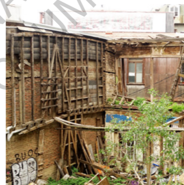
BÂTIMENT EN RUINE APRÈS LE TREMBLEMENT DE TERRE DE 2014 (propriétaire privé) CERRO CONCEPCIÓN Photographie de l'auteure - Juillet 2016
