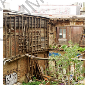
BÂTIMENT EN RUINE APRÈS LE TREMBLEMENT DE TERRE DE 2014 (propriétaire privé) CERRO CONCEPCIÓN Photographie de l'auteur - Juillet 2016
