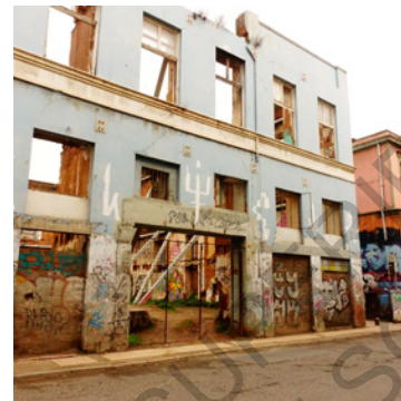
BÂTIMENT DU BARRIO PUERTO EN ATTENTE DE RÉNOVATION Photographie de l'auteur - Juin 2017
