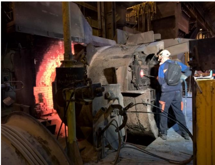
Figures 20 et 21: Opération de changement des plaques du tiroir de la poche
