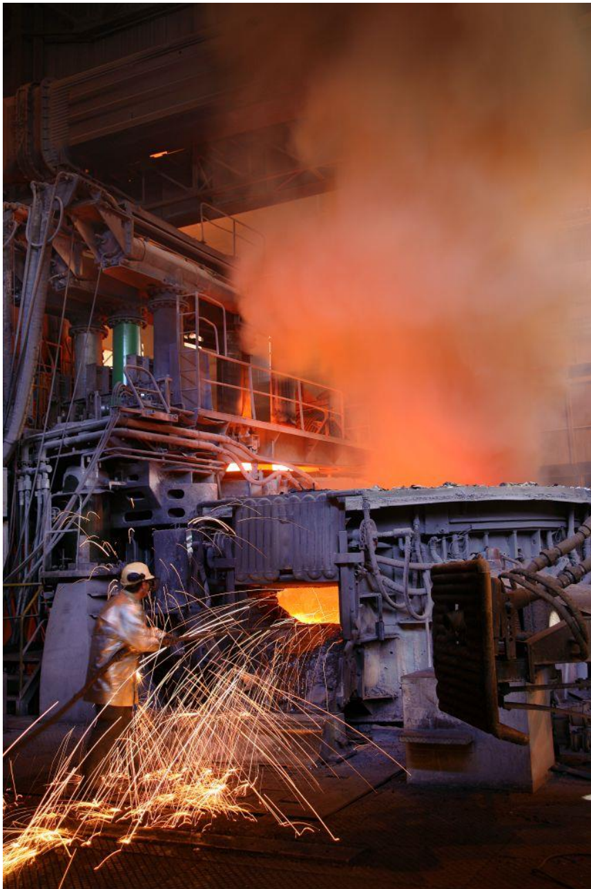
Figure 16: Opération de réparation du four à l'aide d'un béton projeté au travers de la porte du four
