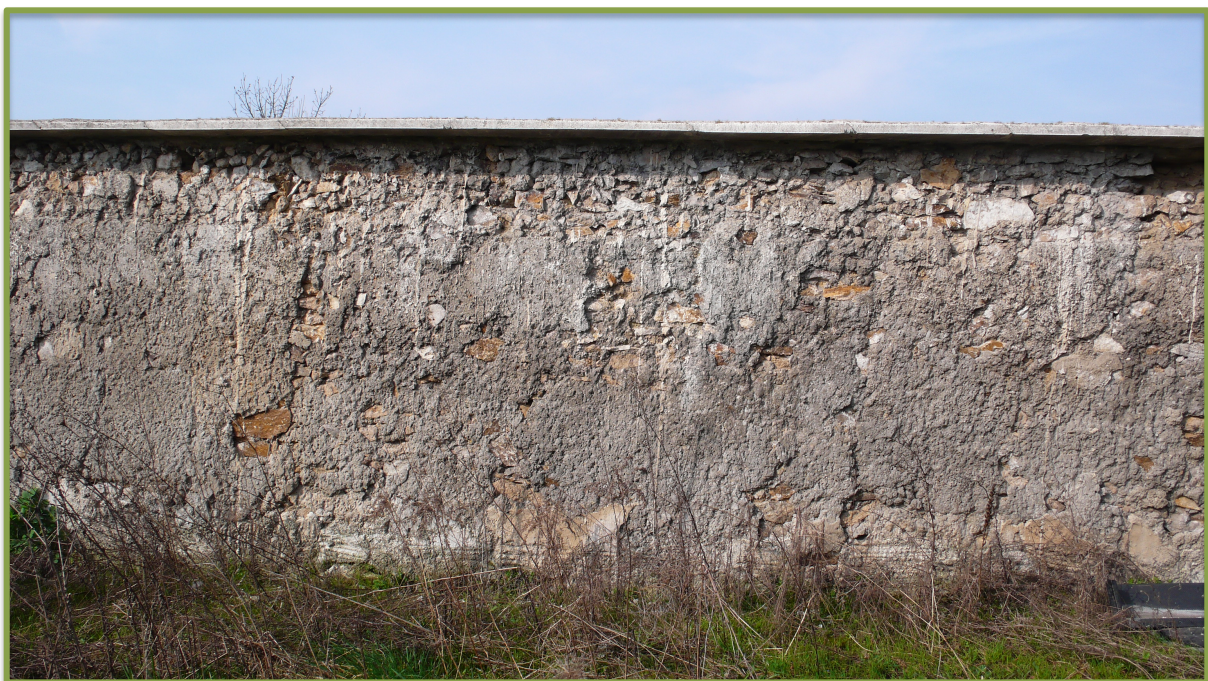
Figure 5: Photographie d'un mur à pêches resté en bon état. (Photo du bureau d'étude Coloco, 2012).
