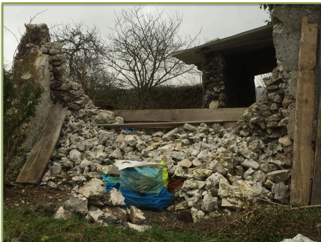
Figure 31: Des murs fortement dégradés...
