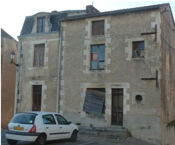
Figure n° 2 : Photo d'un logement vacant et insalubre - commune de Montmorillon (source : dossier de candidature)
