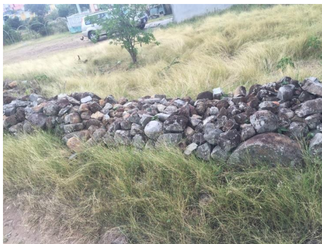
Figure : mur en pierre sèche délabré
