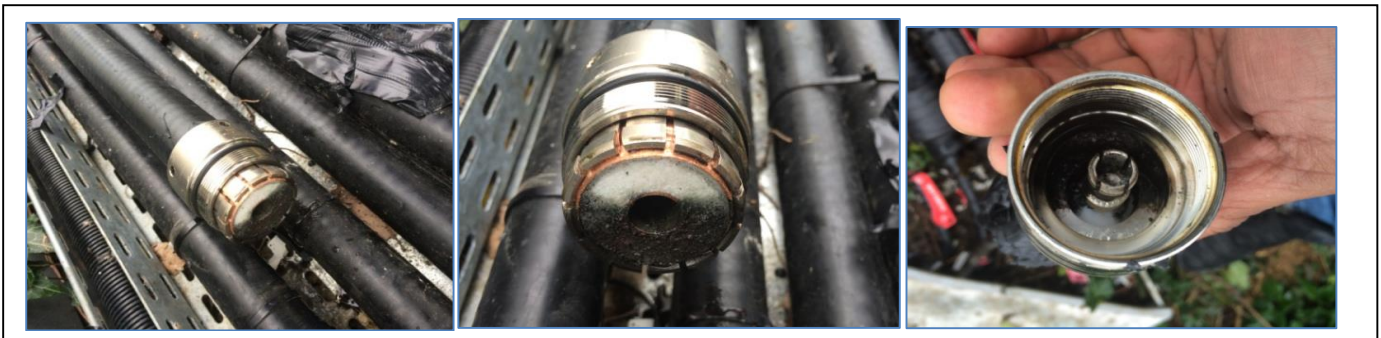
Figure 34 : Photos connecteur endommagé
