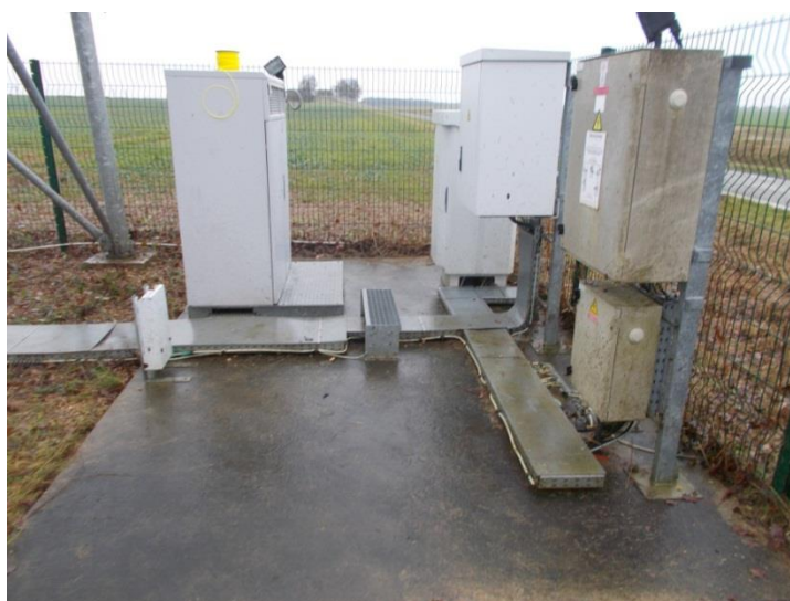
Figure 33 : Site radio sur une terrasse
