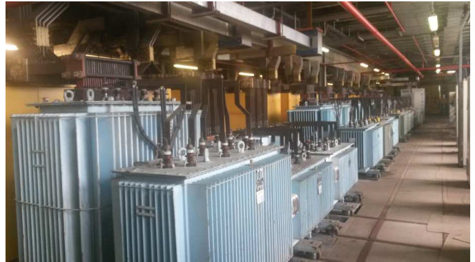
Figure 22 - Selfs + transformateurs + ponts redresseurs LRE1
