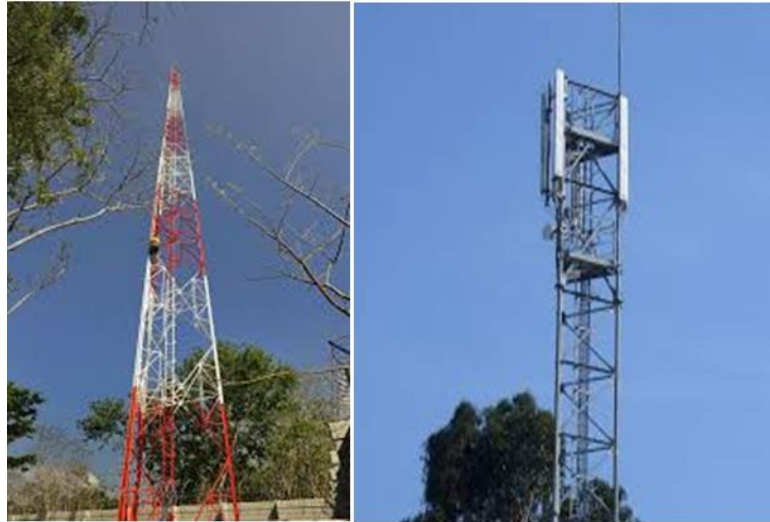
Figure 4: Les pylônes à trois pieds
