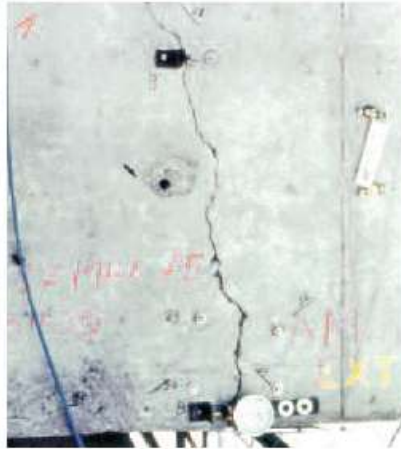
Figure IV.2. Fissures dues à une insuffisance de résistance à la flexion d'une poutre en béton précontraint
