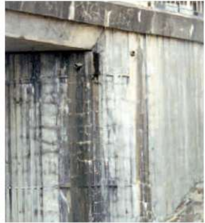
Figure IV.3. Fissuration due à une alcali-réaction du piédroit d'une culée
