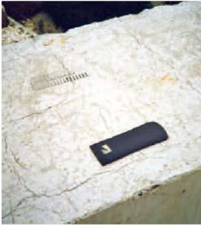
Figure IV.1. Fissures caractéristiques des cassures dites du béton frais.
