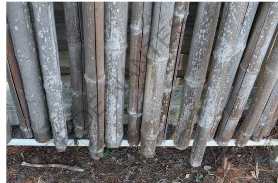
Les chaumes de bambou ne sont plus fixés en partie inférieure et tendent à se détacher de la façade
