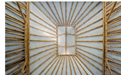
Vue de l'intérieur de la charpente de la maison en Sahrana, Inde, par Pradeep Sachdeva (Minke, 2012)
