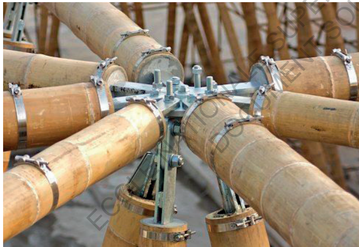
Jointure de la «Maison Chinoise Allemande» à l'exposition universelle de Shanghai en 2010
