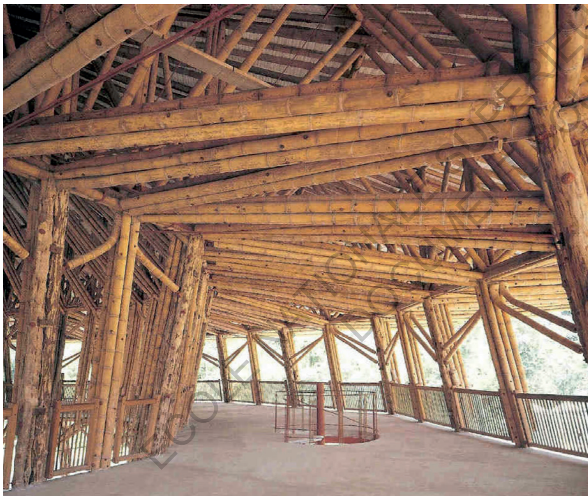
Elément de charpente du Pavillon ZERI de Simon Vélez à l'exposition de Hannover en 2000
