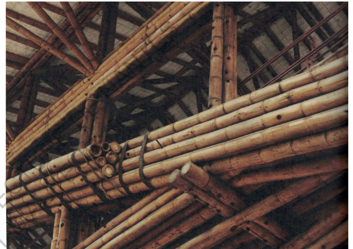
Détail du pont Jenny Garzon à Bogota en Colombie. Architecte : Simon Vélez (Vitra, 2000)
