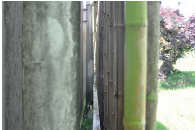
Palissade de bambou à 35 cm de la façade
