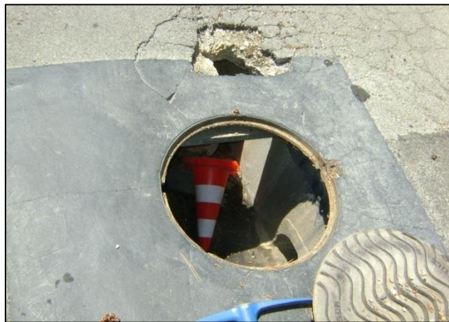
Figure 14. Effondrement d’une partie de la voirie Rue Marius Ruinat
