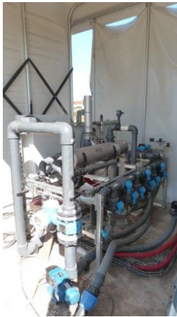
Poste UV dynamique
