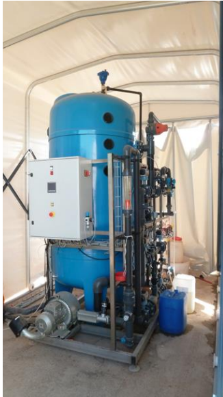
Vue d'ensemble du filtre à sable industriel
