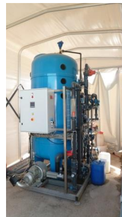
Filtre à sable industriel
