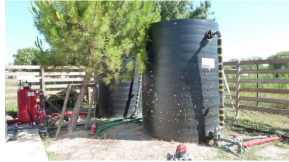
Cuves d'eau traitée (celle en second plan contient le poste d'UV statique)
