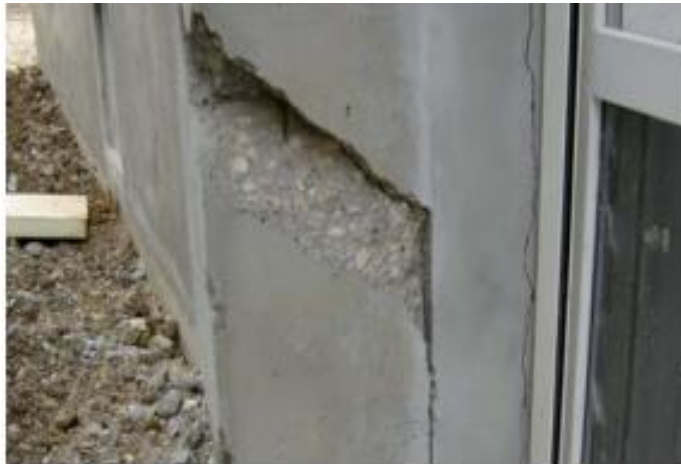
Figure 1-5: Eclatement du béton dû à un choc.
