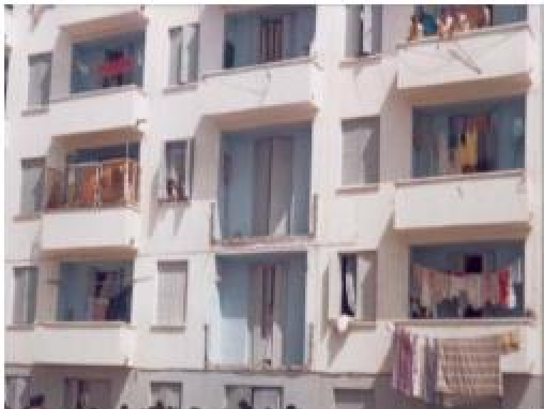
Figure 1-6: Détachement d'un balcon du deuxième étage.
