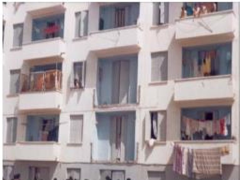
Figure 1-6: Détachement d'un balcon du deuxième étage.
