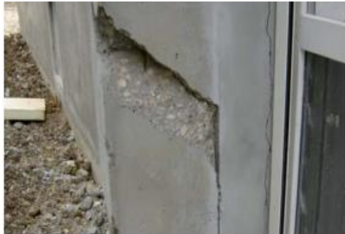
Figure 1-5: Eclatement du béton dû à un choc.
