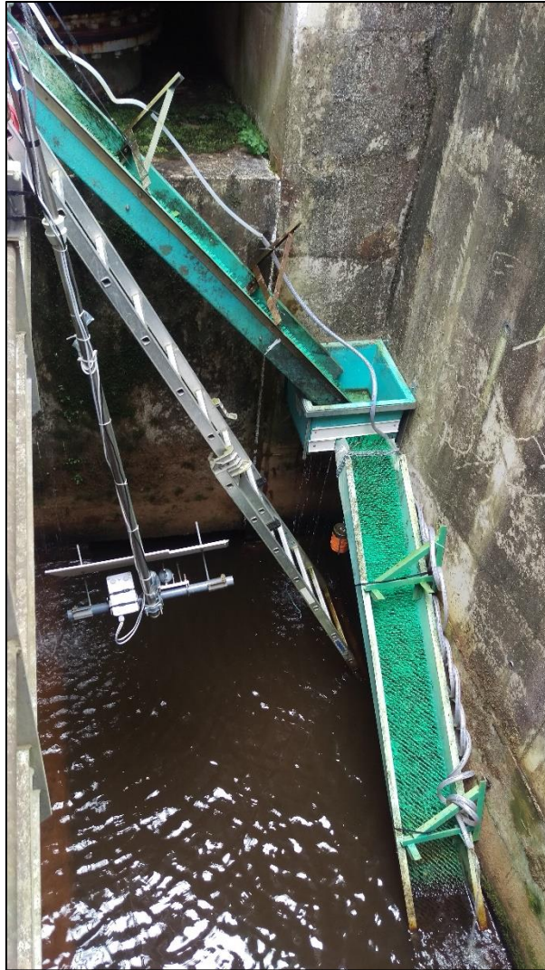
Figure 17: Dispositif de passe-piège utilisé dans le cadre de l'étude (l'entrée de l'écluse Borland se situe à gauche de la passe, sous l'échelle)
