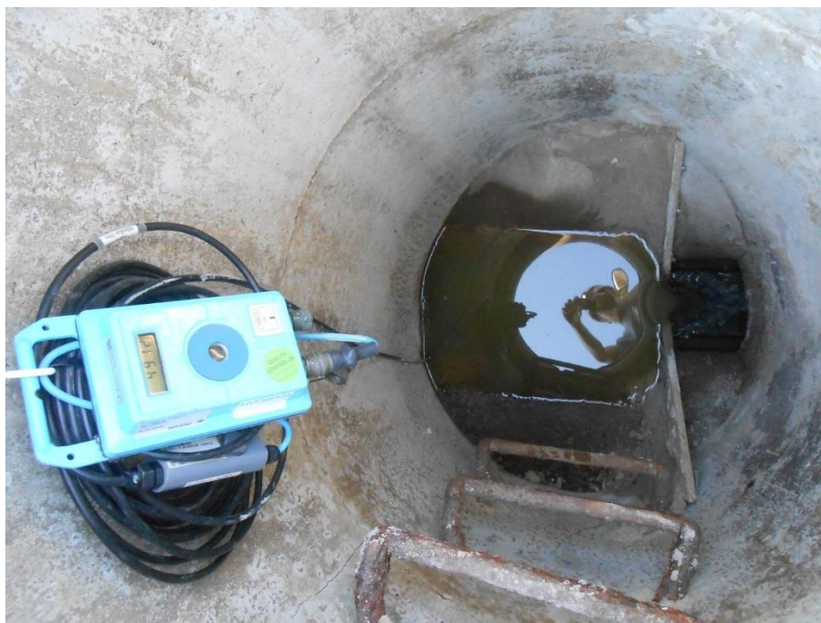
Figure 13 : Photo d'un ouvrage du réseau d'assainissement avec débit mesuré par seuil
