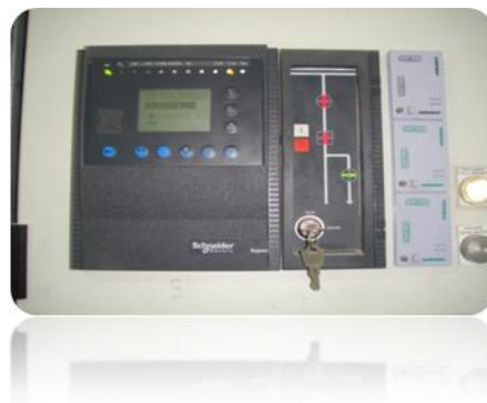
Figure 5: Exemple de relais numérique (SEPAM de Schneider Electric)
