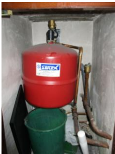
Figure 25 : réseaux au niveau du chauffe-eau
