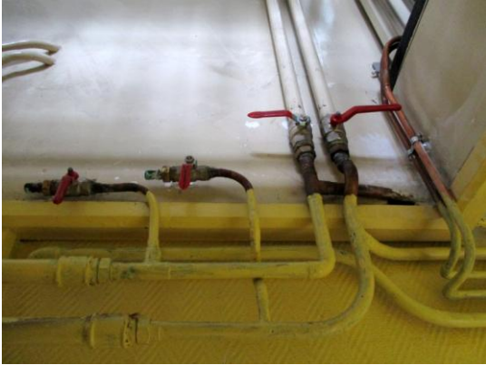
Figure 26 : Photo des canalisations au 1er étage
