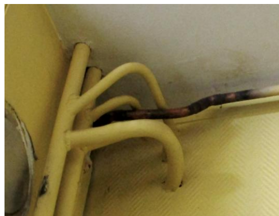
Figure 23 : Photo de ces mêmes canalisations au niveau du premier étage
