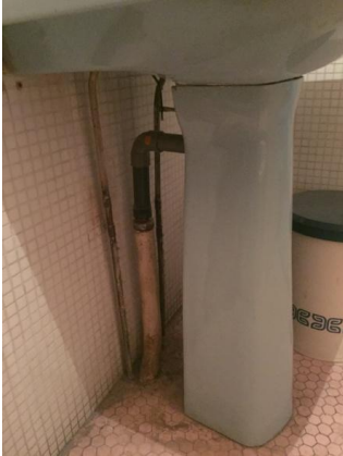
Figure 27 : Photo du lavabo situé au deuxième étage
