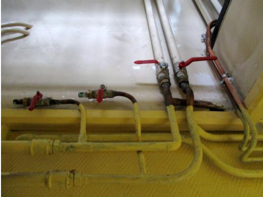
Figure 26 : Photo des canalisations au 1er étage
