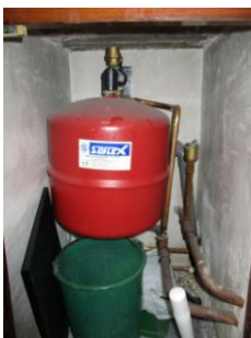
Figure 25 : réseaux au niveau du chauffe-eau
