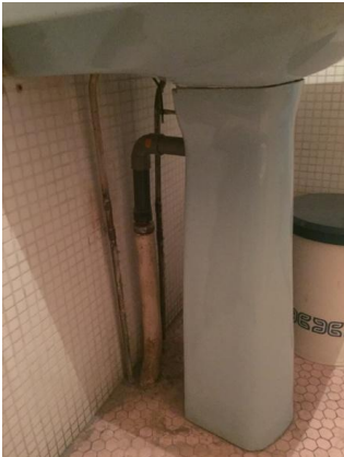
Figure 27 : Photo du lavabo situé au deuxième étage
