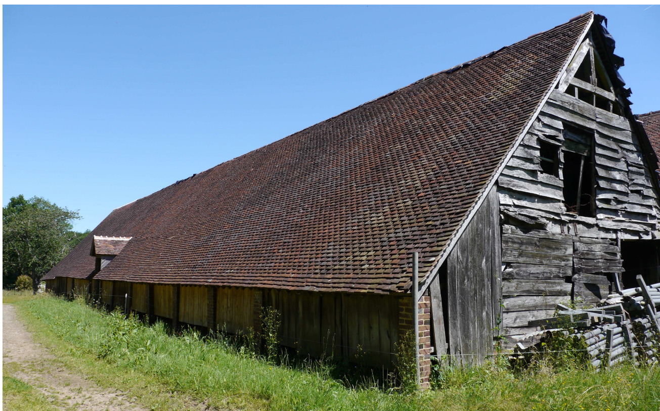
Bâtiment principal avec toiture en tuile espacée afin de permettre le séchage des produits
