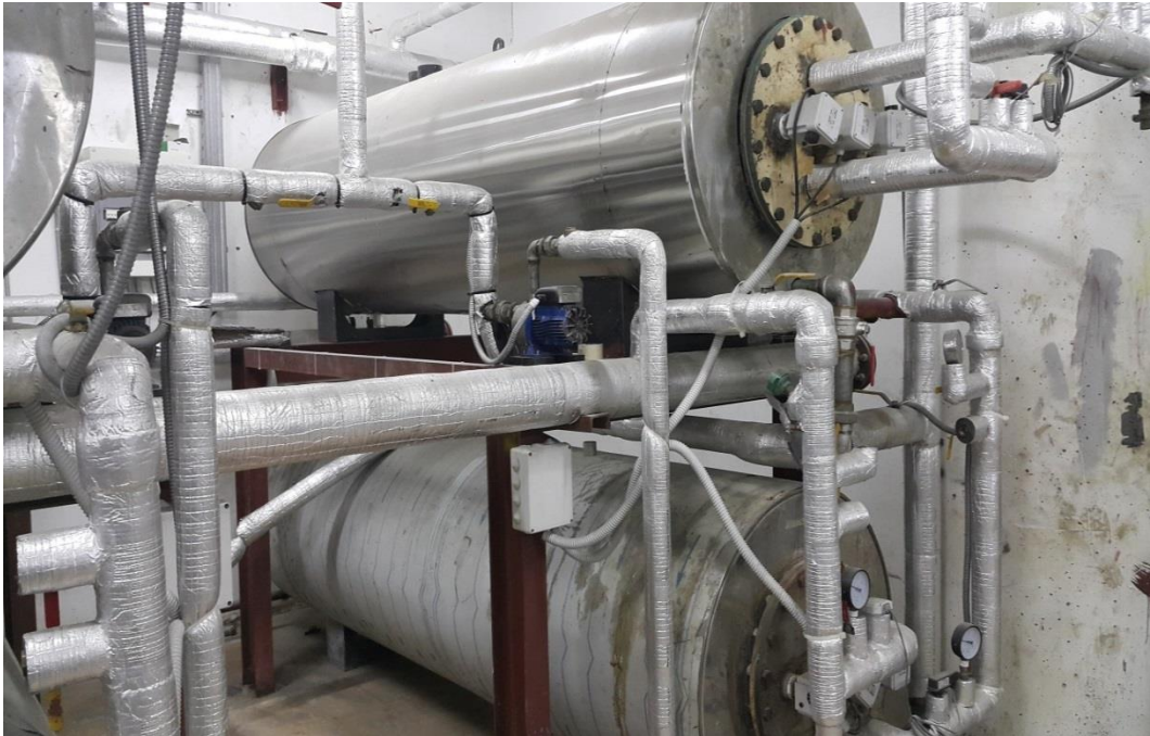
Figure 6: Vue extérieure de deux réservoirs d'eau chaude, installés dans 'Arizona Gym'.
