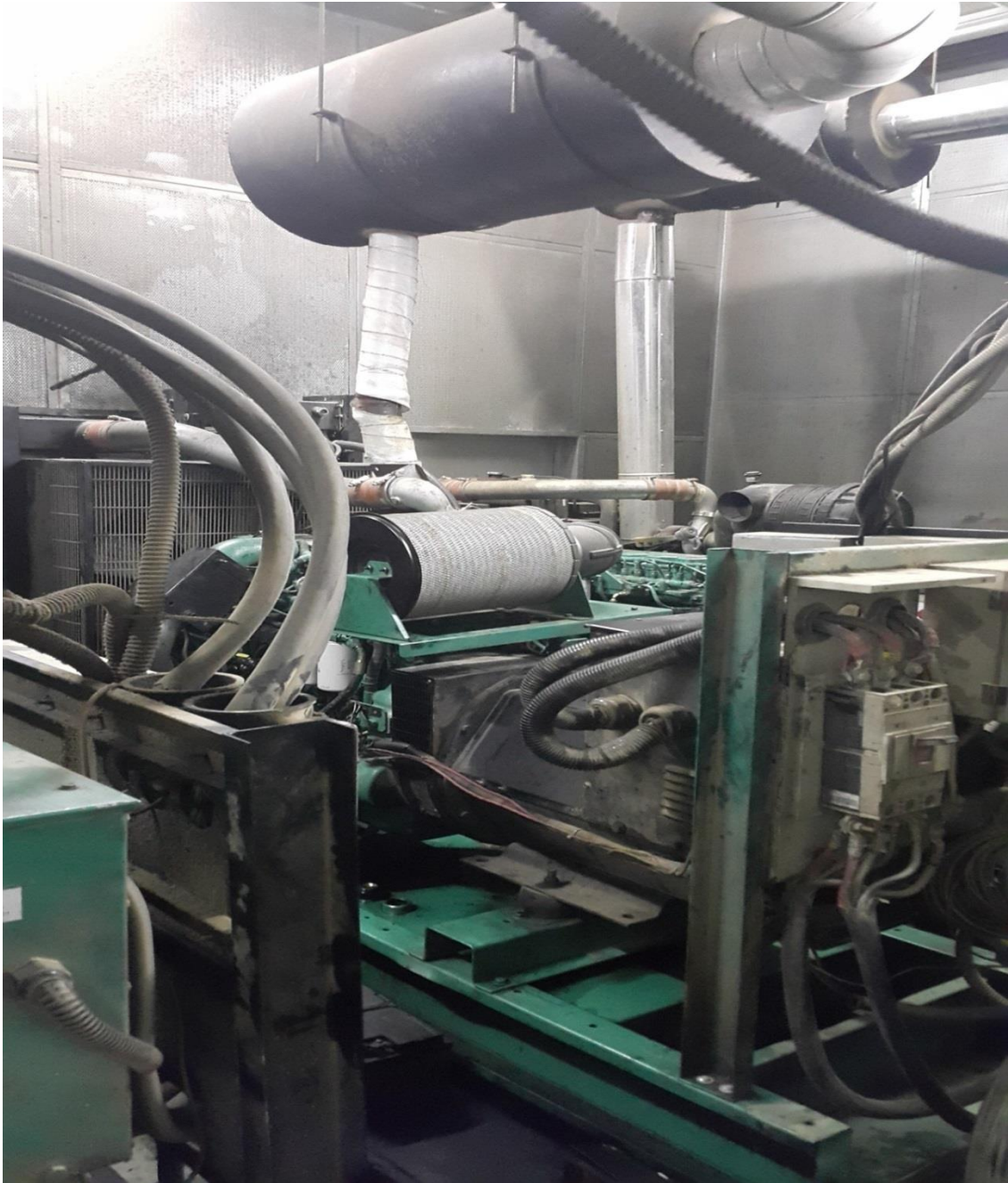
Figure 12: Vue extérieure d’un générateur installé dans ‘Arizona Gym’.
