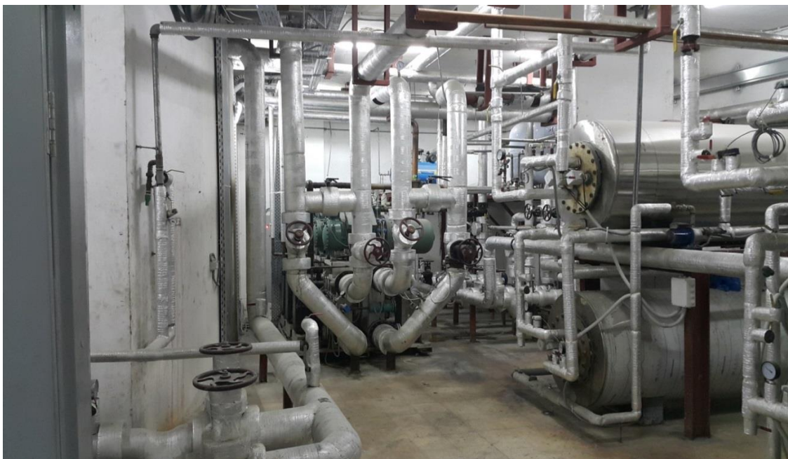
Figure 11: La chambre contenant le refroidisseur avec ses équipements.
