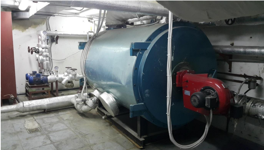
Figure 7: Vue extérieure d'une chaudière installée dans 'Arizona Gym'.
