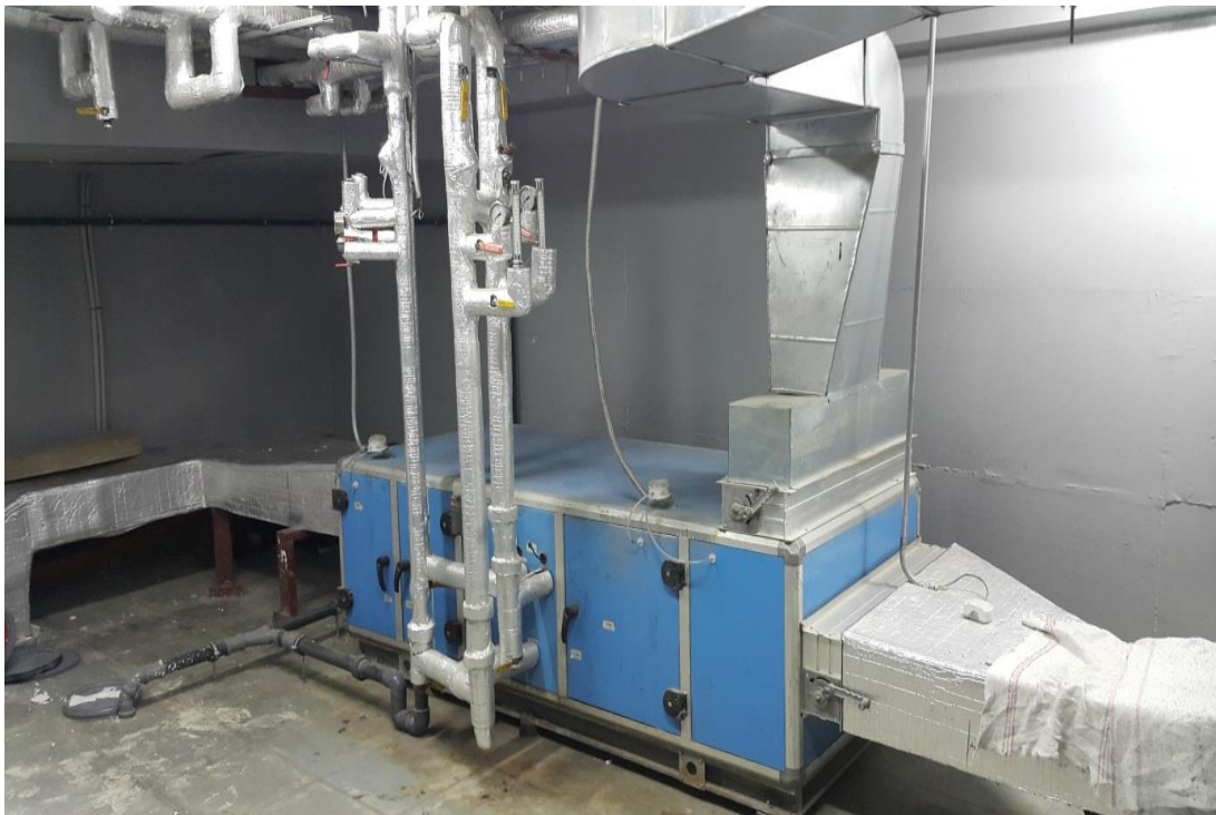
Figure 4: Vue extérieure d'un AHU installé dans 'Arizona Gym'.
