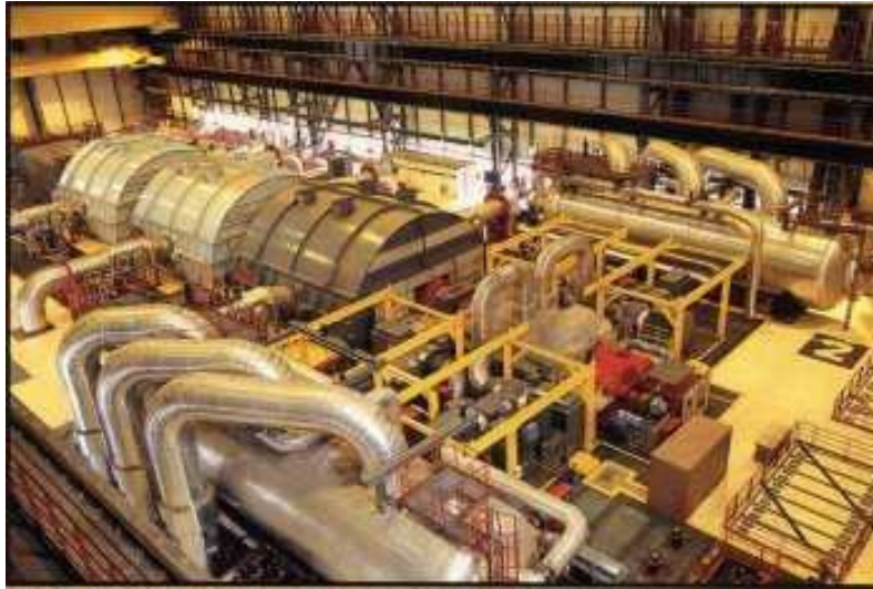
Figure 2 : Turbine à vapeur de 1300 MW
