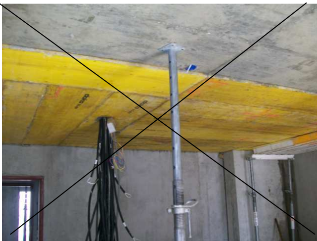
Situation à éviter
