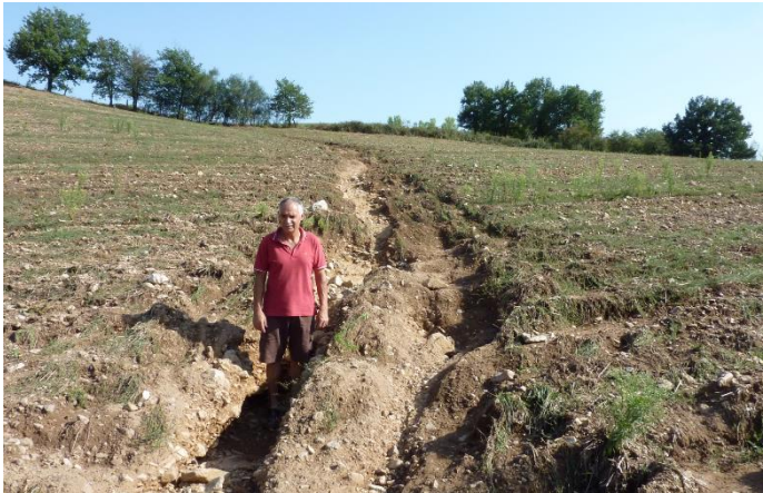
Figure 4 : Formation de ravines après un gros orage sur le bassin versant du Vendailles en août 2011 (photo : SMRCV)
