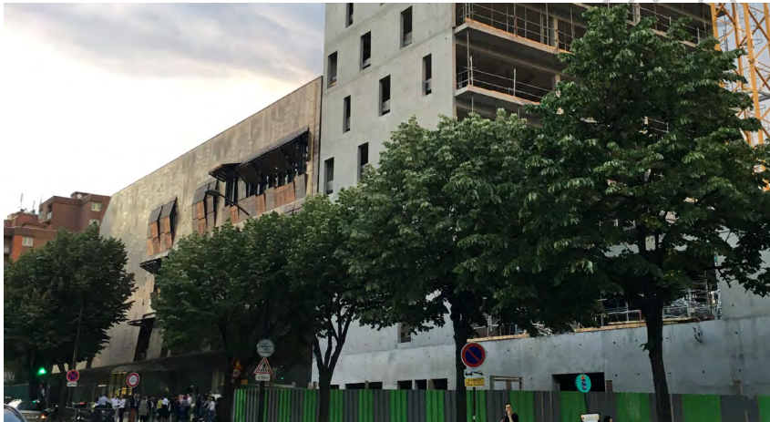
Fig 75. A gauche le conervatoire Claude Debussy et à droite le chantier du CEJ
