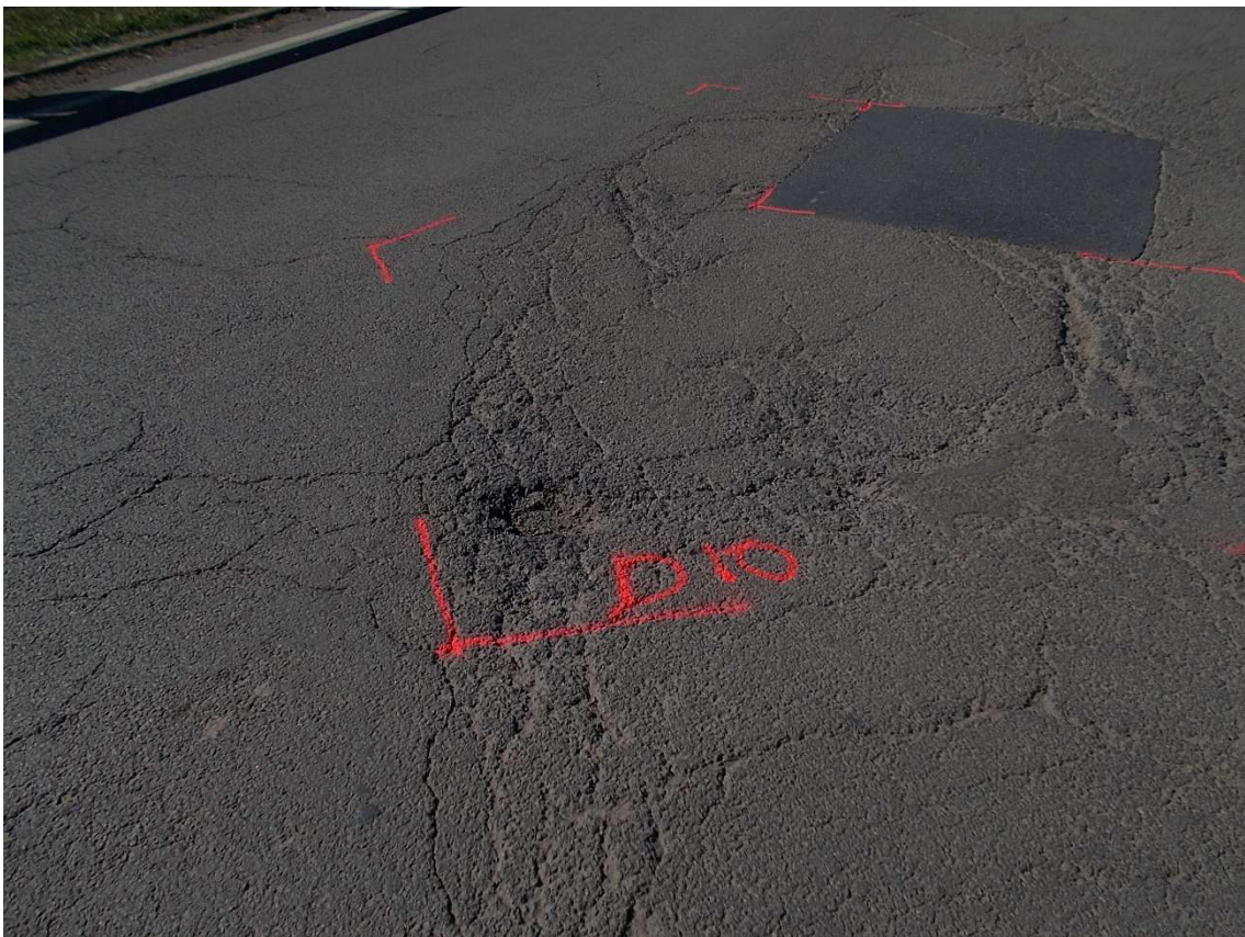
Figure 24 : Photographies des désordres observés sur le site de Noyelles-Godault
