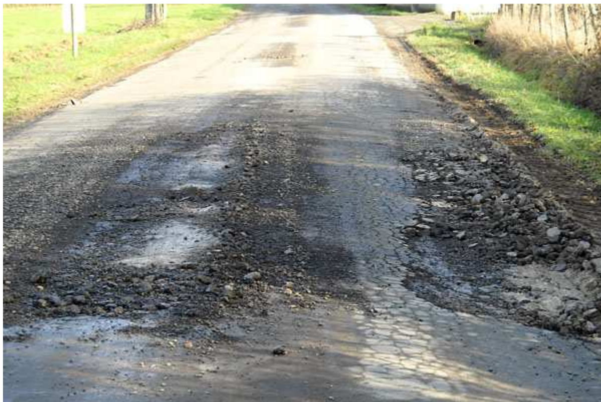
Figure 21 : Effets de la circulation sur une chaussée à la suite d'un phénomène de succion cryogénique (Source : Conseil Départemental des Deux-Sèvres)
