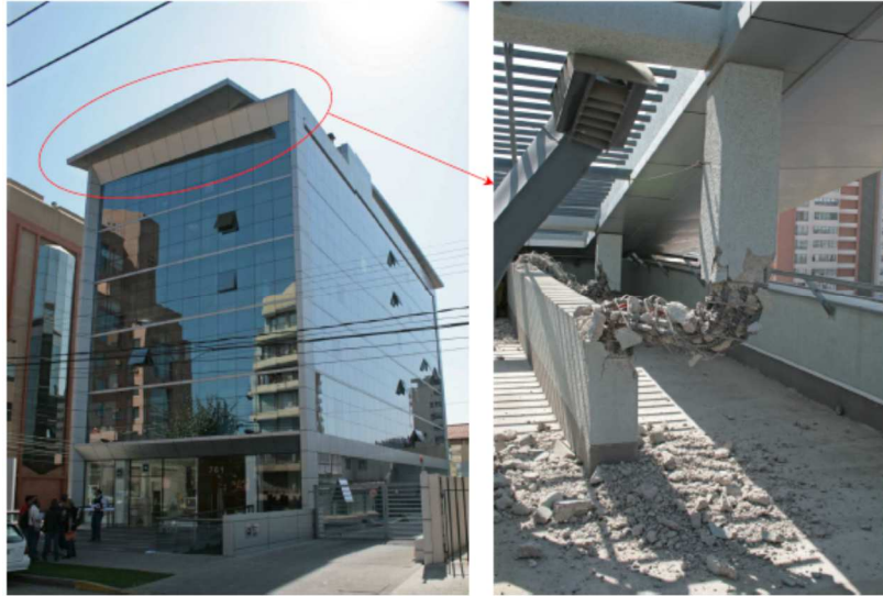
Figure 72 Illustration du phénomène « coup de fouet » sur le dernier niveau d'un immeuble
