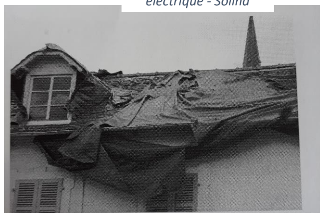
Document 61 : Toiture dégradée - Soliha
