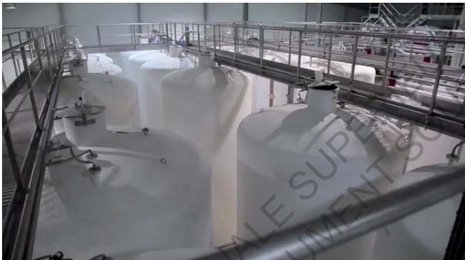
Vue sur les cuves
