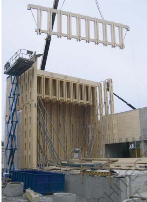
mise en place des poutres et des poteaux à l'aide d'une grue. la rigidité totale du bâtiment n'est obtenue qu'après la pose des panneaux de façade nécessaire au contreventement. Illustration : JKMM Architects
