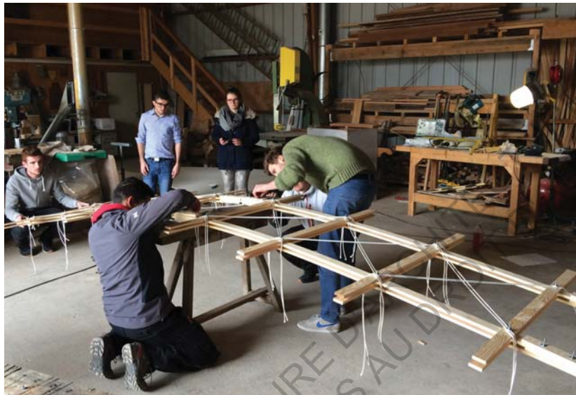
1. grille plane : la grille est assemblée, les cordes de contreventement sont mises en place sans être tendues. Elles sont simplement passées dans les mâchoires et légèrement pincées. Les articulations à chaque nœud sont libres. Illustration : mathieu sudres
