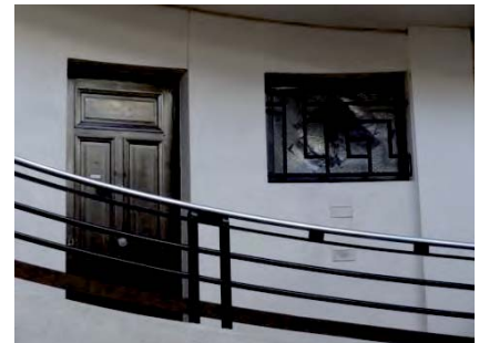
Photo 26 : vitre brisée par les pompiers
