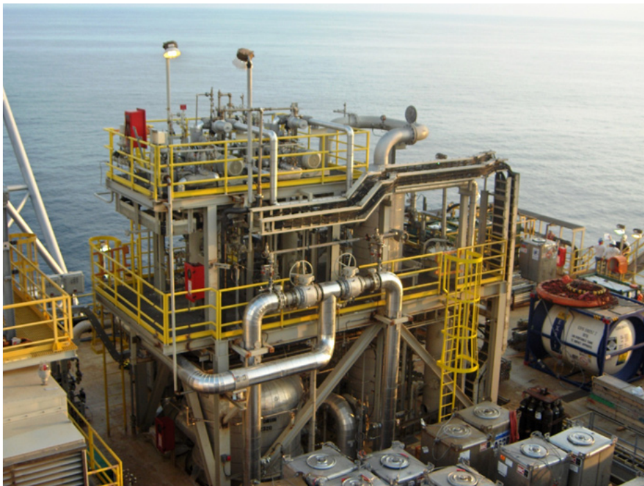
FIGURE 2.3 – Module de récupération MEG, plateforme en mer, USA
