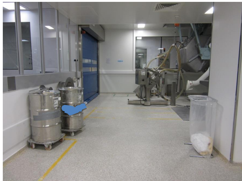
Figure 14 : Vue partielle de la salle de mélange du produit X
