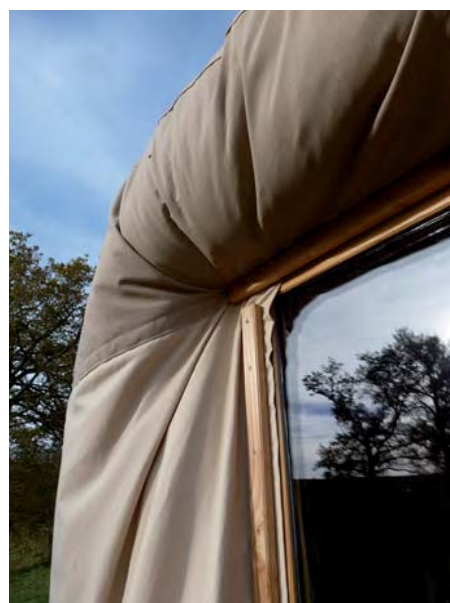
Photos prises le 12/11/2015 [Menuiseries de l'entrée / Jonction pieux-plancher / Raccord toile-menuiseries]
