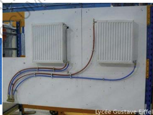
Figure 75: Installation PER pour chauffage.
