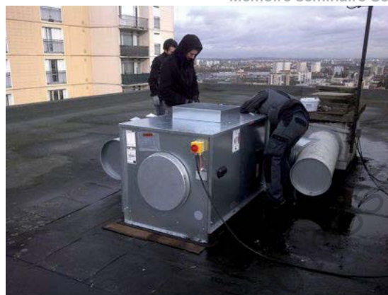
Figure 13: Installation d'un caisson VMC acier en extérieur pour logement collectif
