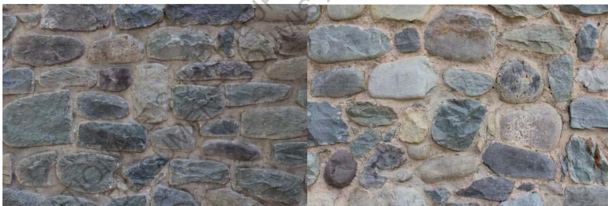
Mur de pierre à la construction initiale – Secondary School S.22 – Image personnelle Mur de pierre de l'extension – Secondary School S.22 – Image personnelle
