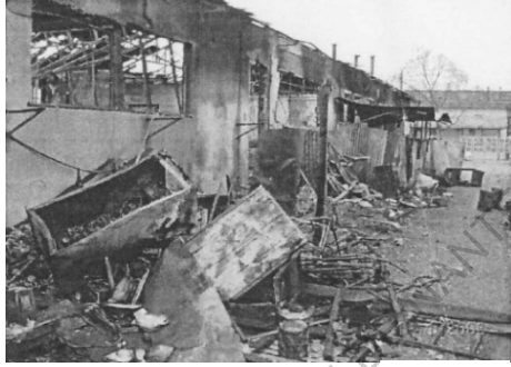
Photos : CEP Les décombres du bâtiment V
