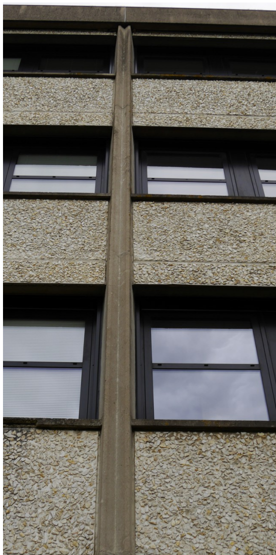
Fig. 59: Photographie de la poutre séparant deux travées sur les corps de bâtiment d'enseignement et vue des modules en pierres lavées ainsi que des menuiseries.
