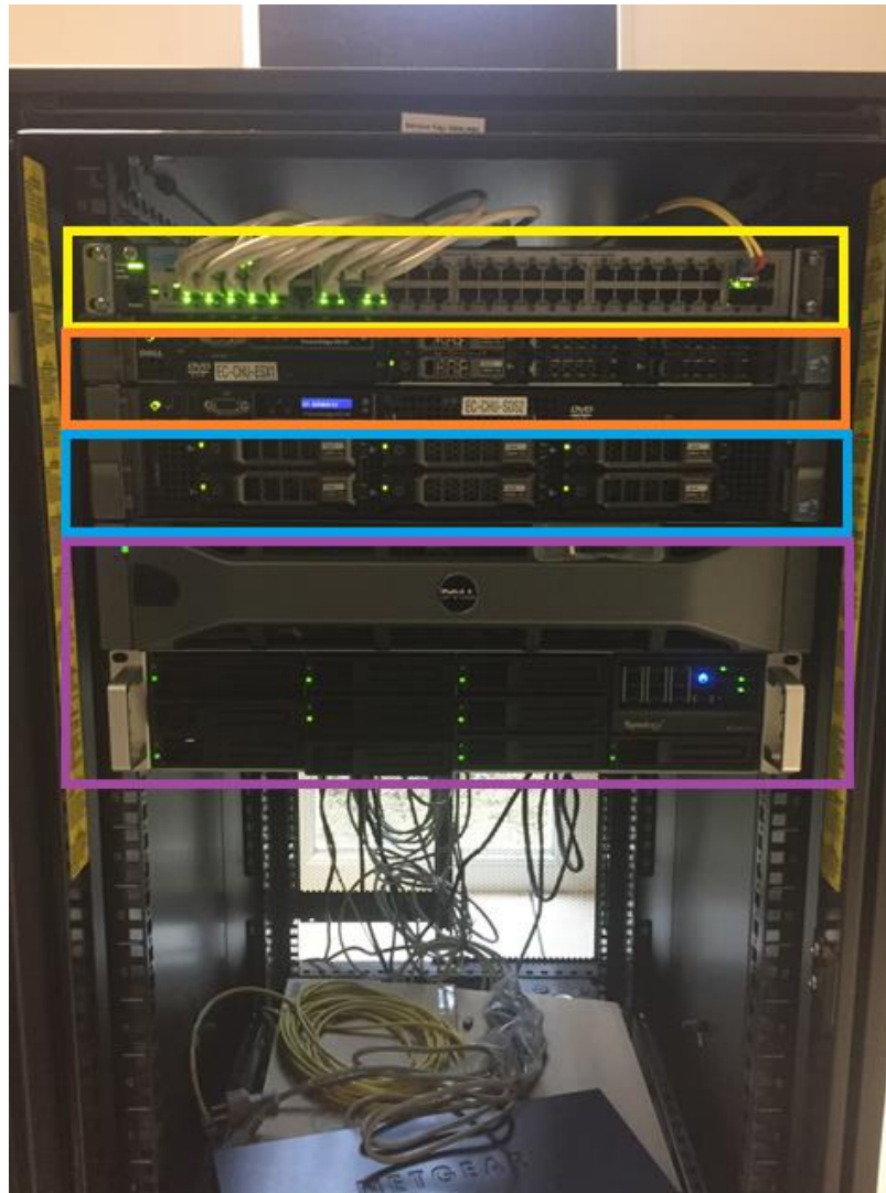
Figure 52 : Baie informatique Echo sur la salle blanche (Echo)
