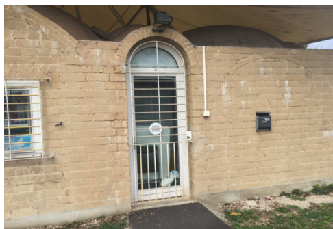
Figure 9 : Traces d'eau sur la façade Sud de la maison. Production personnelle
