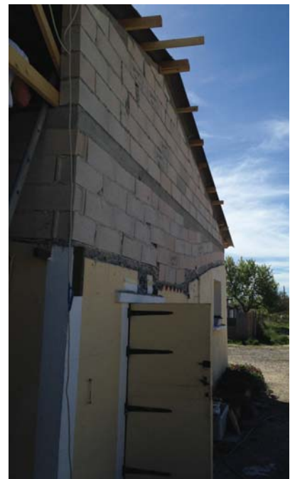
Figure 5 : Travaux de rehaussement de toiture, sans permis, Carteau Sud. Source : E.H.
