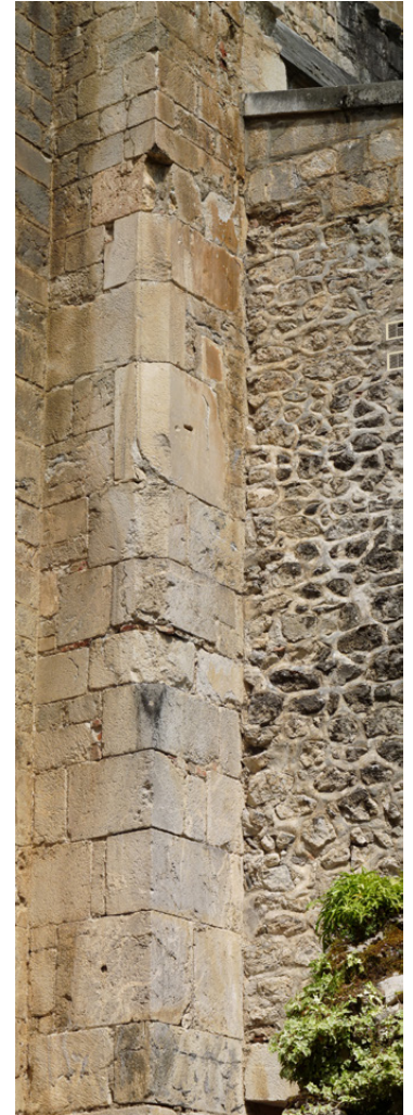
Figure 55 : Façade sud : Chanfrein sur l'arête du contrefort oriental de la 1ère travée.
