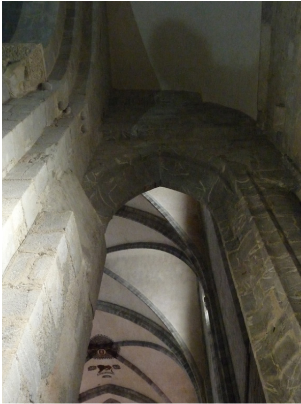
Figure 82 : 1ère travée, pilier à ressauts sud : pilastre bûché au sud, et ressaut coupé pour l'insertion de l'arc en lancette gothique.
