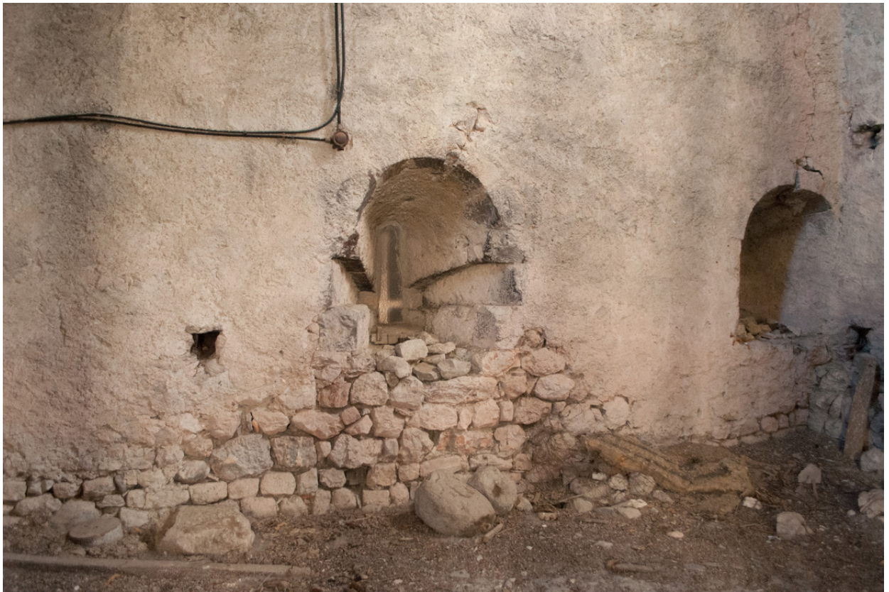
Figure 98 : Salle haute, mur est : jour inférieur médian.
