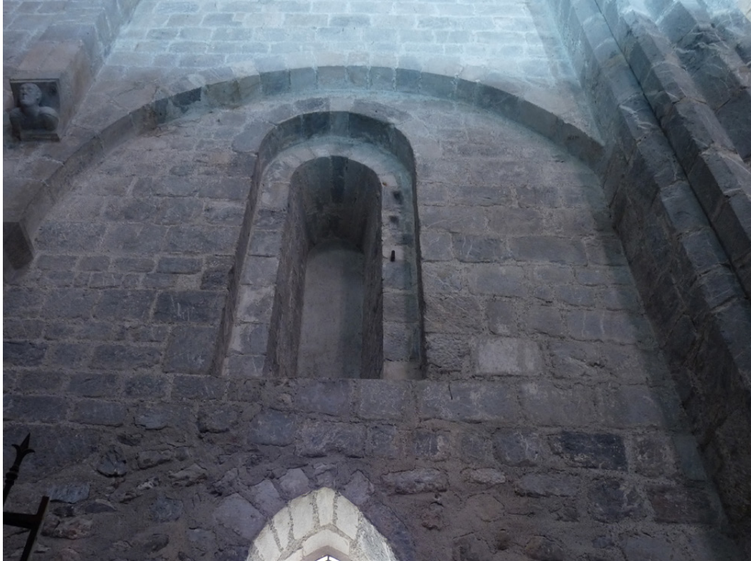
Figure 77 : 3ème travée, mur gouttereau nord : baie en plein cintre murée sous l'arc oriental.
