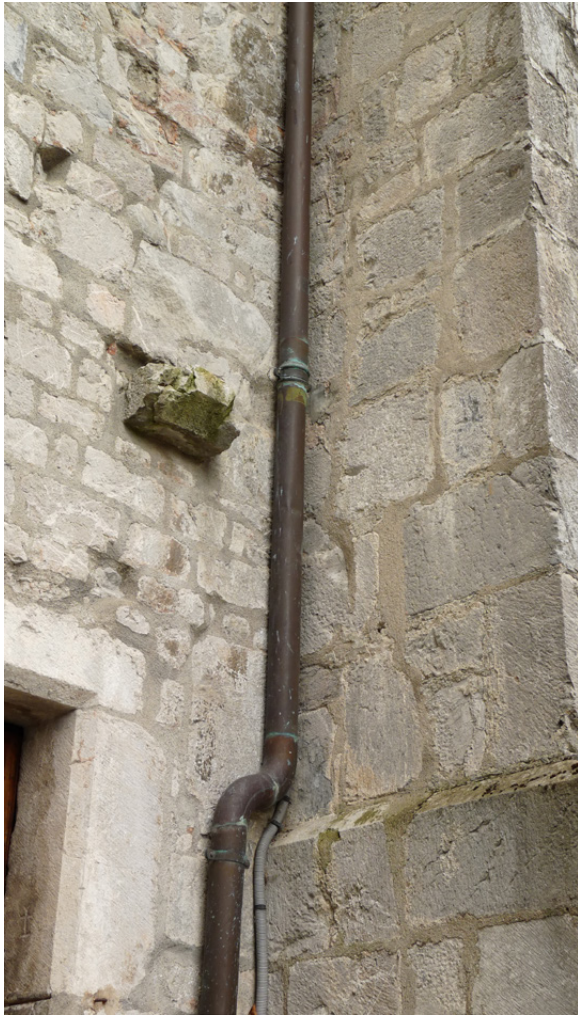
Figure 48 : Façade nord, 3ème travée : chaînage avec le contrefort ouest, bas du mur.
