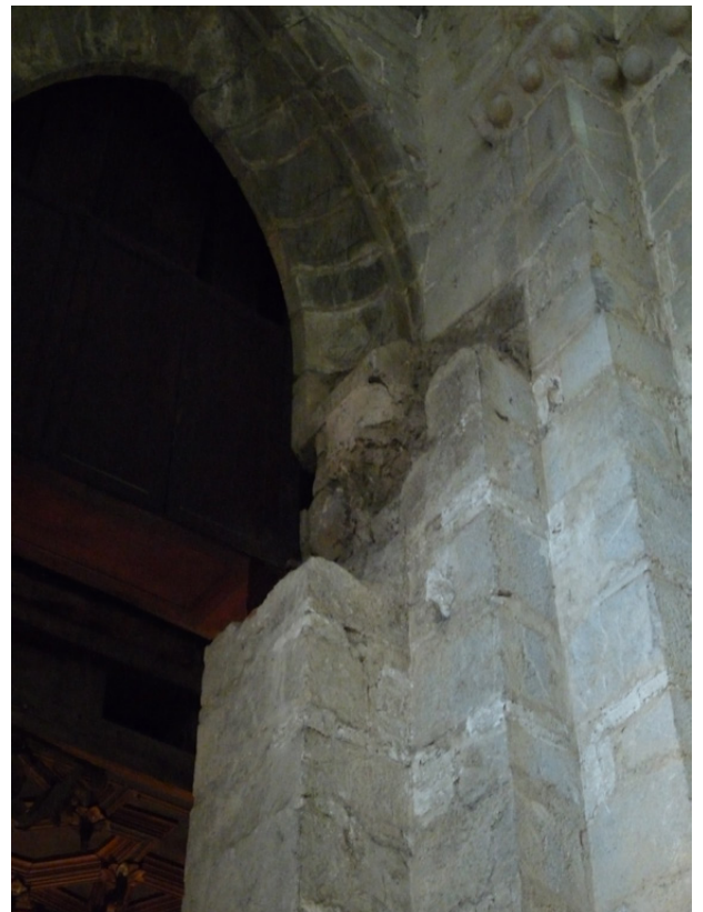
Figure 81 : 1ère travée, pilier à ressauts nord : détail du pilastre coupé pour l'insertion de l'arc en lancette gothique.
