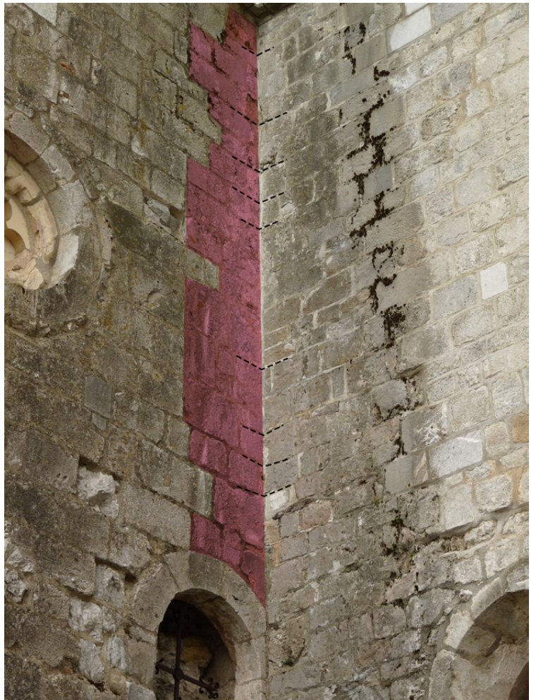
Figure 50 : Façade nord : contrefort oriental de la 3ème travée (en rose) sur lequel s'appuie le mur ouest de la chapelle de Castillon.
