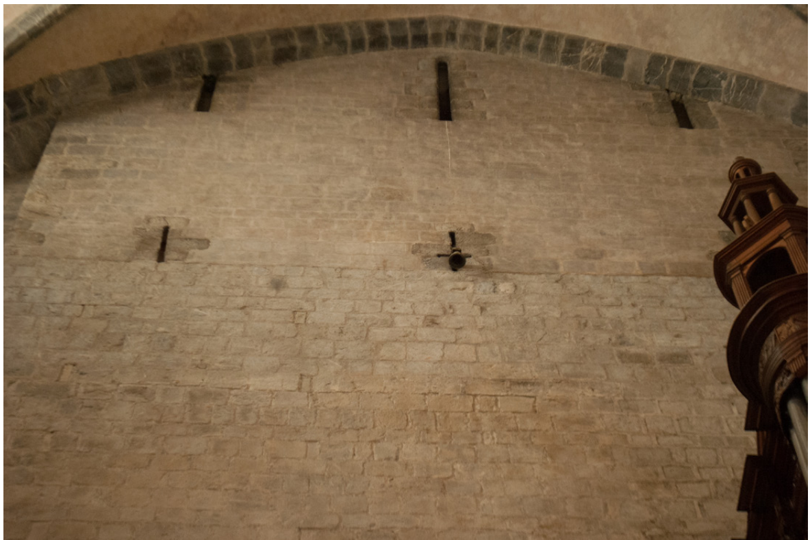
Figure 30 : Enduit peint du sommet du mur est du clocher sous la voûte gothique.
