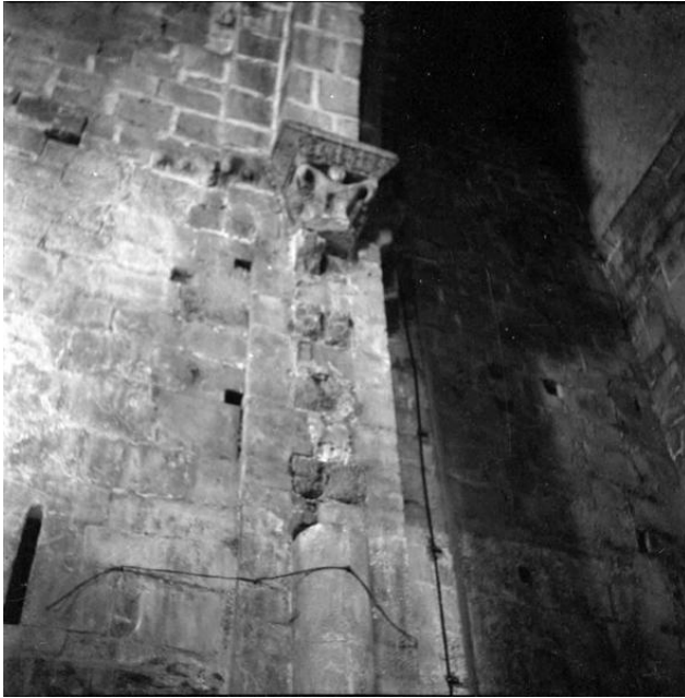
Figure 13 : Colonne engagée nord au revers de la façade avant restauration. Photographie de Robert Vassas, 1948, n°44L04547, MAP.
