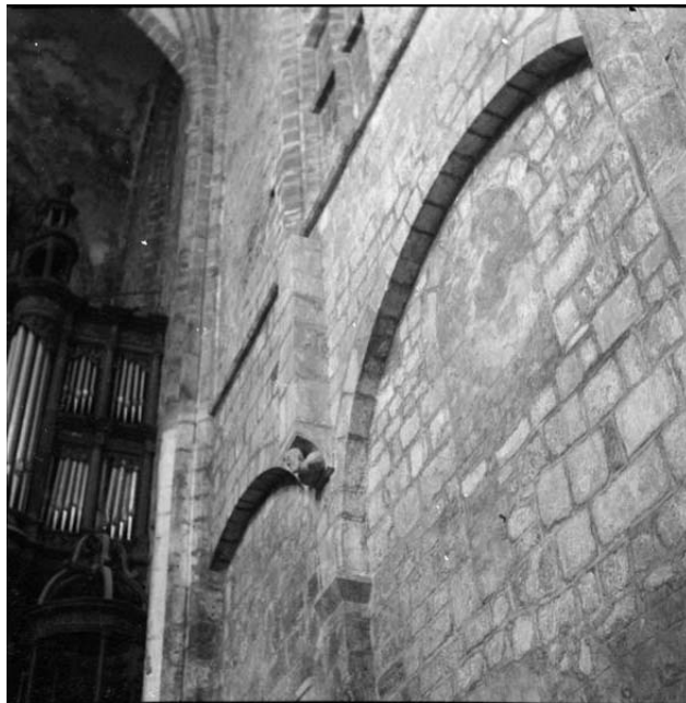
Figure 15 : Mur sud de la 3ème travée : baie murée, avant restauration. Photographie de Sylvain Stym-Popper, n°44L04538, MAP.
