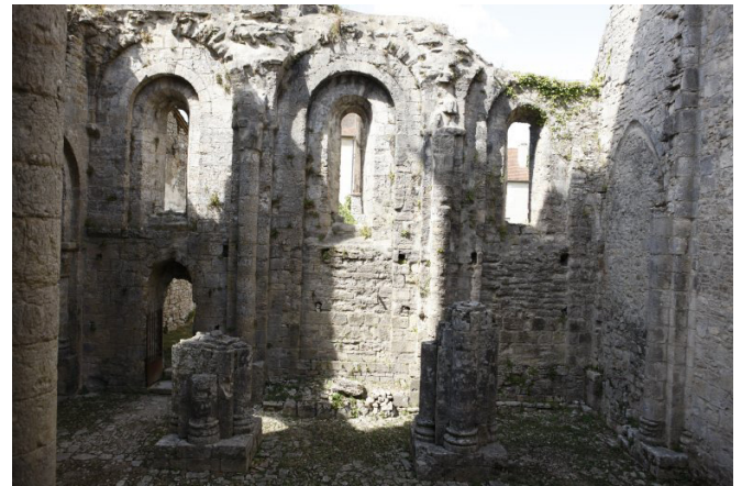
Figure 130 : Ancienne abbatale Saint-Pierre de Marcilhac-sur-Célé (Lot) : collatéral nord. (crédit : Philippe Poitou, Inventaire général Midi-Pyrénées)
