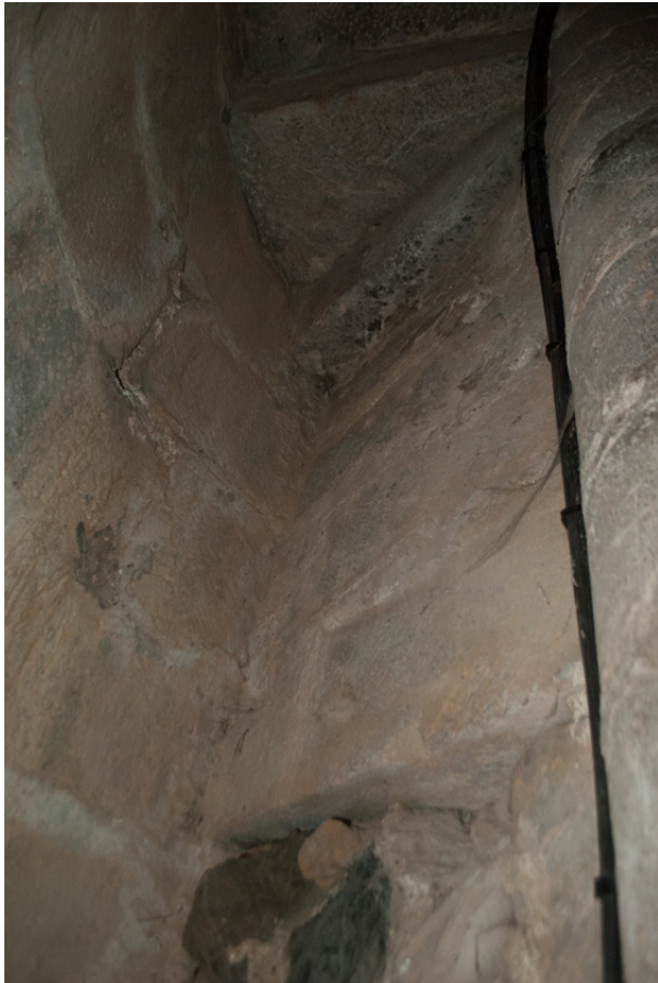
Figure 88 : Escalier du clocher : fin de la voûte hélicoïdale, début des marches à angles vifs.
