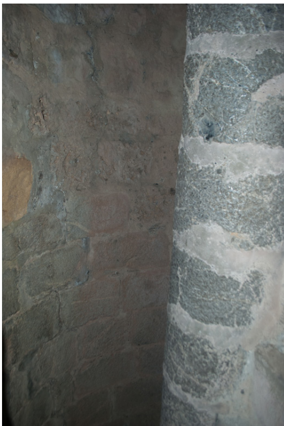
Figure 94 : Fin du parement roman de la cage d'escalier, reconstruction (XIXe siècle?) en assises irrégulières et joints beurrés.
