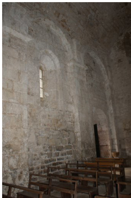
Figure 142 : Église Saint-Michel-de-Rouviac de Nant (Aveyron) : vue du mur gouttereau sud. (crédit : Françoise Gallès, Inventaire général Midi-Pyrénées)
