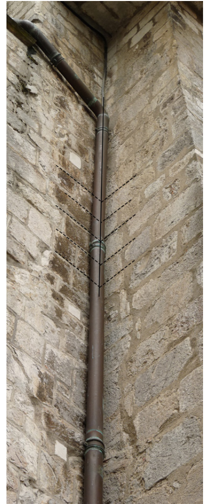
Figure 49 : Façade nord, 3ème travée : chaînage avec le contrefort ouest, haut du mur.
