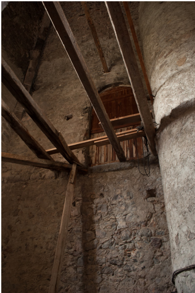
Figure 103 : Salle haute, mur ouest : parement irrégulier en partie inférieure du mur.
