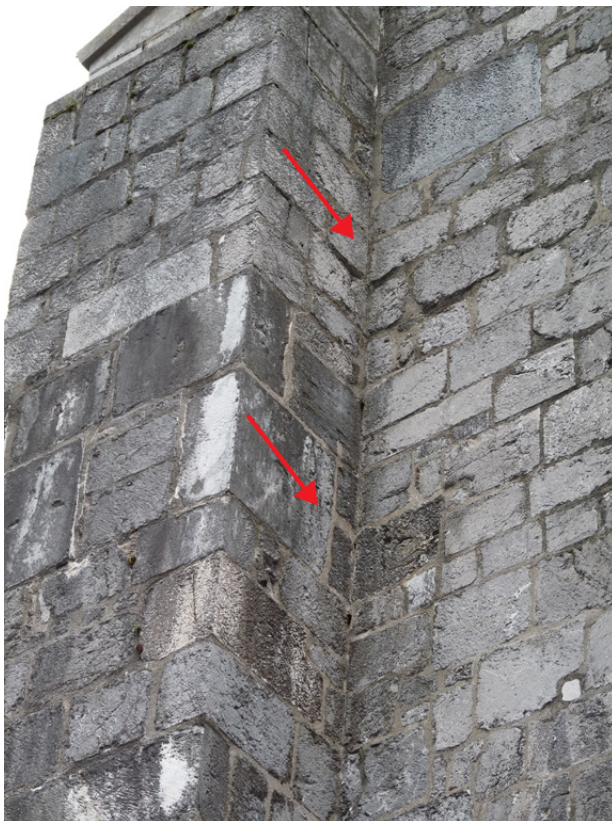
Figure 34 : Détail du chaînage entre le mur pignon nord et le contrefort (flèches indiquant certains des points de chaînage).
