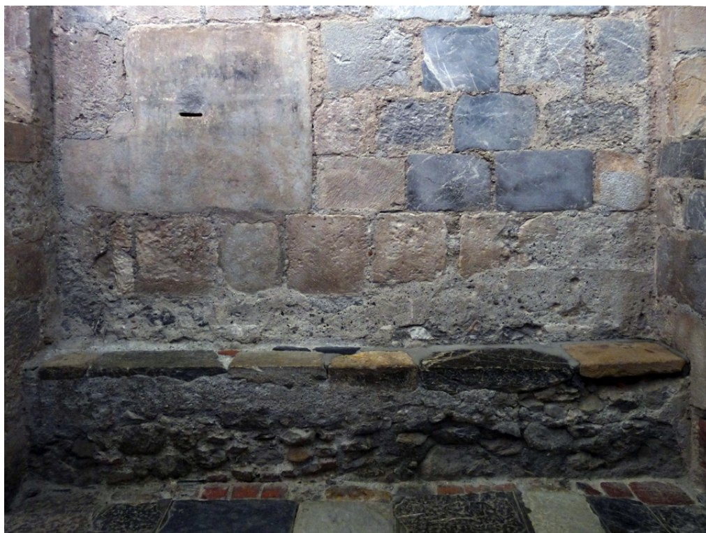
Figure 22 : Mur sud de la 4ème travée : banquette diminuée en hauteur et bûchage enduit.
