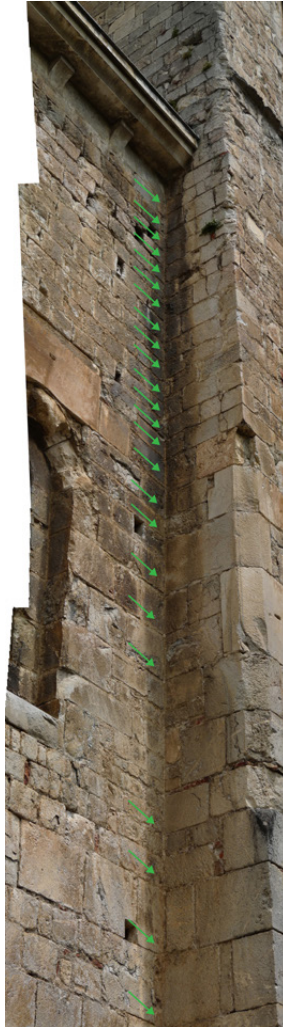
Figure 54 : Façade sud, 1ère travée : chaînage avec le contrefort est, indiqué partiellement par les flèches. Photo-montage.
