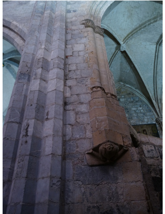
Figure 79 : 4ème travée, côté sud : maçonnerie reprise à l'est de la chapelle de Cosnac.
