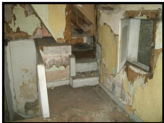
Figure 17 : Immeuble sous DUP, 3 Place Reine Marguerite Source : SIAB
