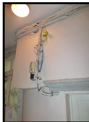
Figure 33 : Dysfonctionnements dans les parties communes Source : SIAB
