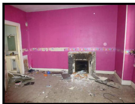
Figure 35 : Dégradation d'un appartement Source : SIAB
