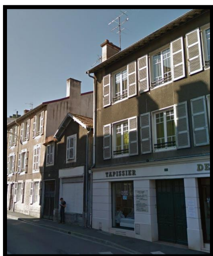
Figure 25 : Désordres structurels au 23 rue Carrérot Source : Google Map
