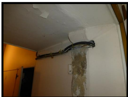
Figure 32 : Parties communes dégradées Source : SIAB
