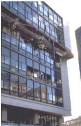
Figure 1.1.1: Destruction des étages dus à la rotation des planchers.
