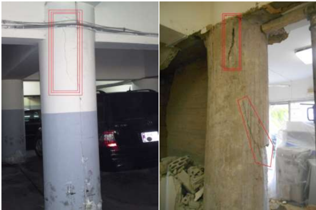
Figure 5.1.4 : Fissurations apparues sur les poteaux.
