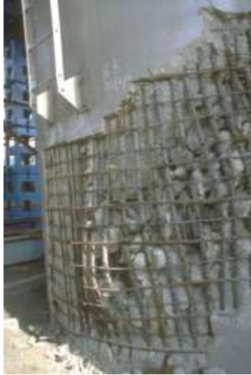
Figure 1.1.2 : Eclatement du béton en pied du poteau.
