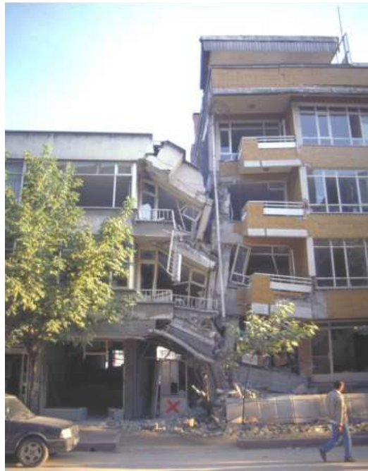
Figure 2.6.8 : Deux bâtiments entrechoqués en l'absence de joints parasismiques.
