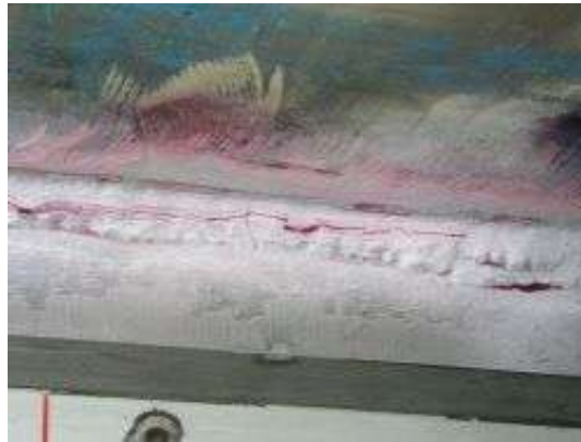
Figure 2.3.6 : Fissures détectées par la méthode de ressuage.
