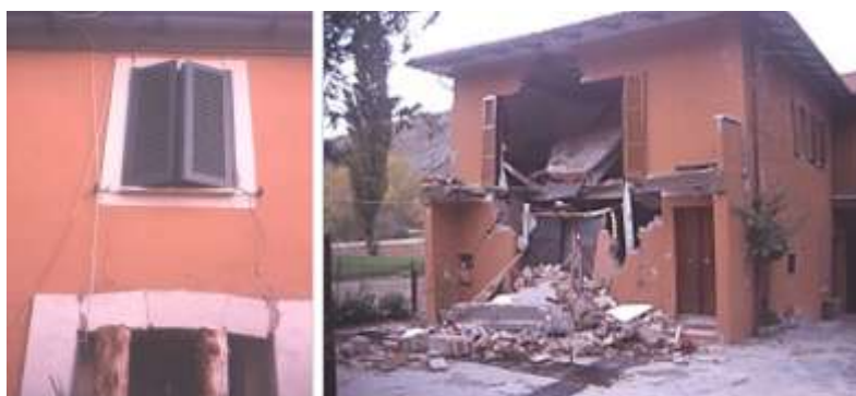
Figure 2.6.7 : Destruction d'une façade causé par des ouvertures.
