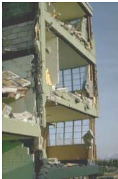
Figure 1.1.4 : Désolidarisation de la façade.
