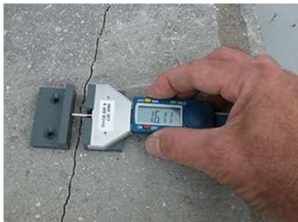
Figure 2.3.7 : Evolution d'une fissure par un fissuromètre.
