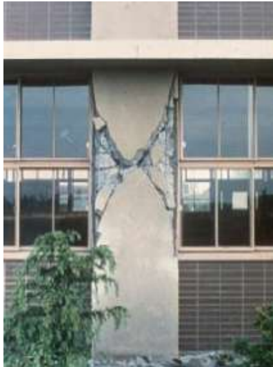
Figure 1.1.3 : Dégradation du béton autour des ouvertures.
