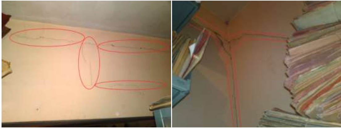
Figure 5.1.3 : Fissurations dans les murs de remplissages et leurs intersections.
