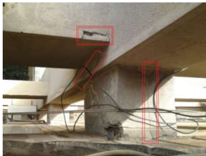
Figure 5.1.5 : Fissurations apparues sur les poutres.
