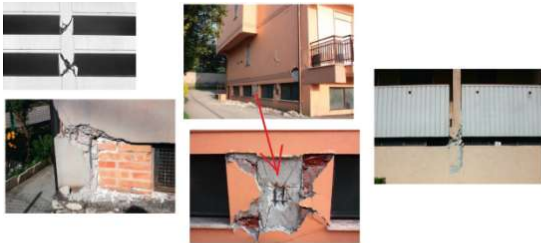
Figure 2.6.6 : Destruction des poteaux courts durant un séisme.
