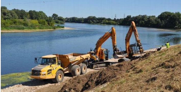
Figure 6: Travaux de renforcement de la levée de Loire à Mareau-aux-Prés en septembre 2016 ©Patrick Lebaupin, 2016, https://www.larep.fr/mareau-aux-pres/2016/09/12/des-travaux-pour-prevenir-les-inondations_12067569.html (Consulté le 5 septembre 2018)
