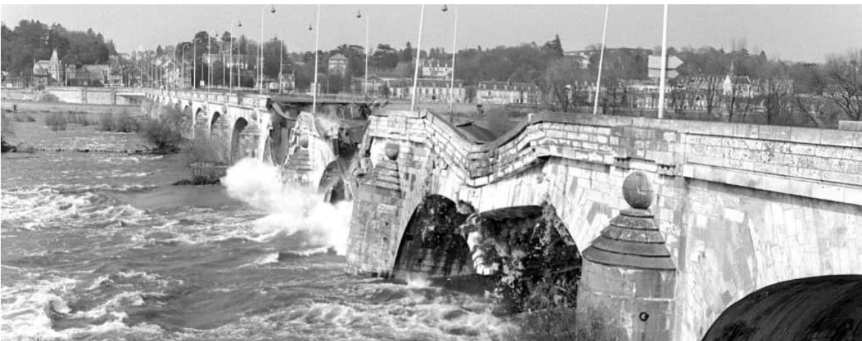
Figure 7: L'effondrement du Pont Wilson à Tours le 9 avril 1978 ©Pierre Fitou, La Nouvelle République 1978, https://www.lanouvellerepublique.fr/tours/il-y-a-quarante-ans-le-pont-wilson-a-tours-s-effondrait (Consulté le 19 Juillet 2018)
